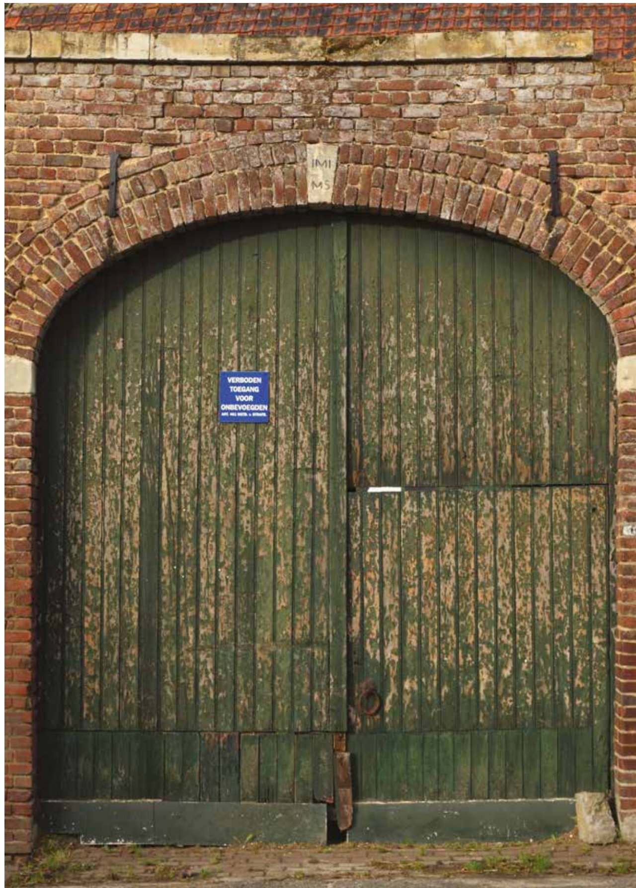
Door langdurige leegstand dreigen monumentale hoefes te vervallen. Foto: Erwin Zijlstra, Gelders Genootschap, 2018.
