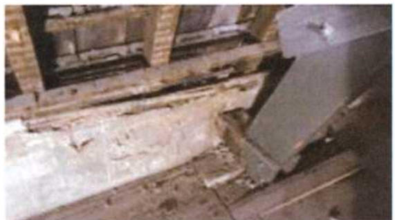
Borstwering en aantasting hout spantconstructies
