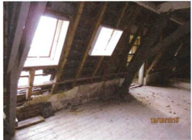
Brokstukken op zoldervloer
