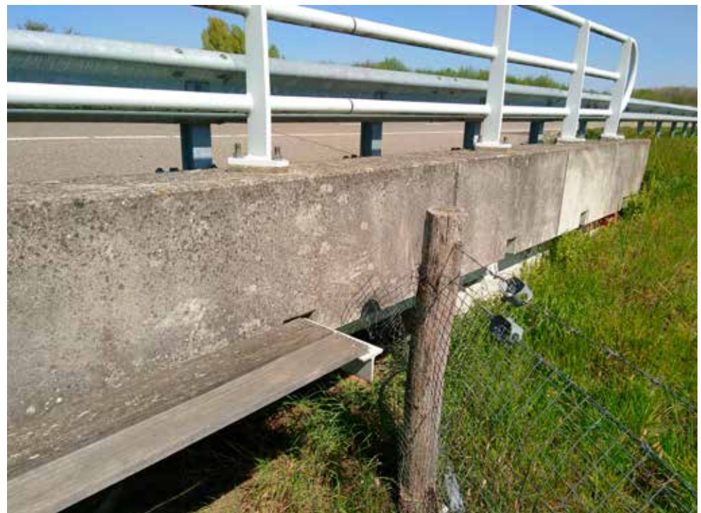
Loopplanken sluiten niet aan op talud (foto: Jeroen Mos)
